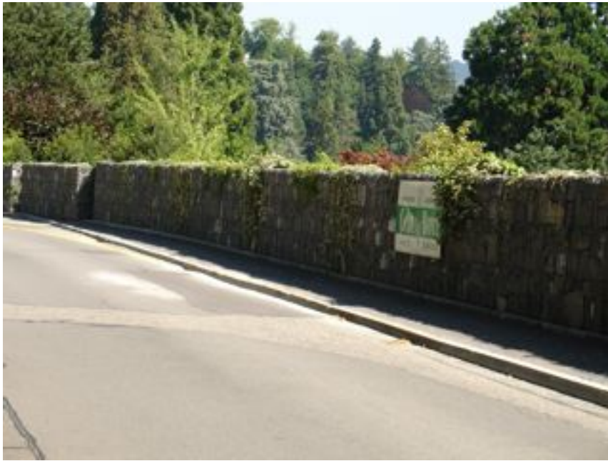
Abb. 1: Neu erstellte, rund 60m lange und 1.5m hohe Mauer an der St. Niklausenstrasse.
